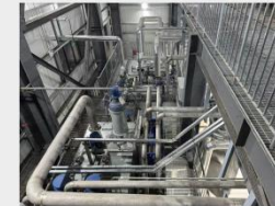
荣翔石化高压凝水综合利用能源站
